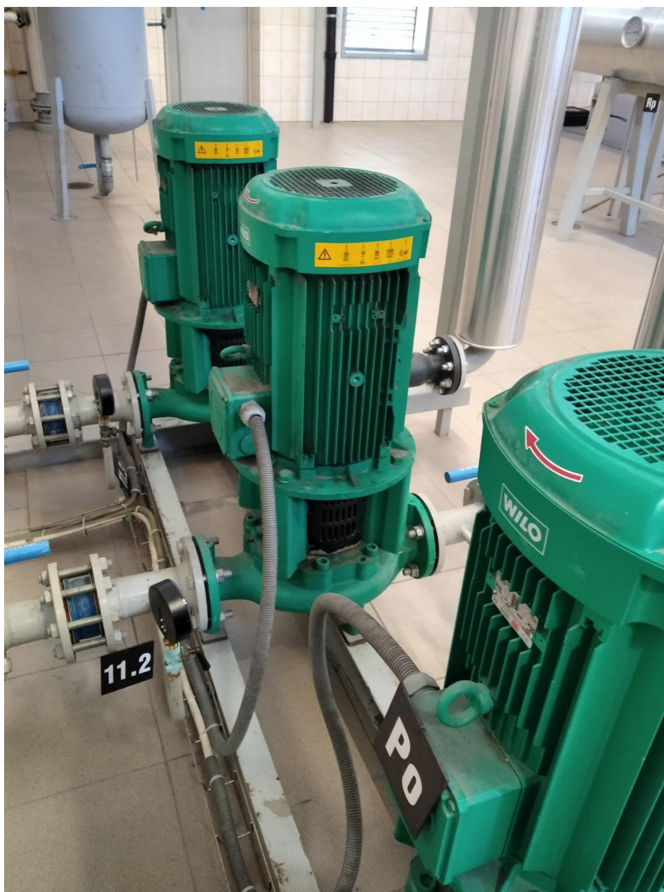
Rysunek 3.1.10 Widok pomp wody sieciowej
